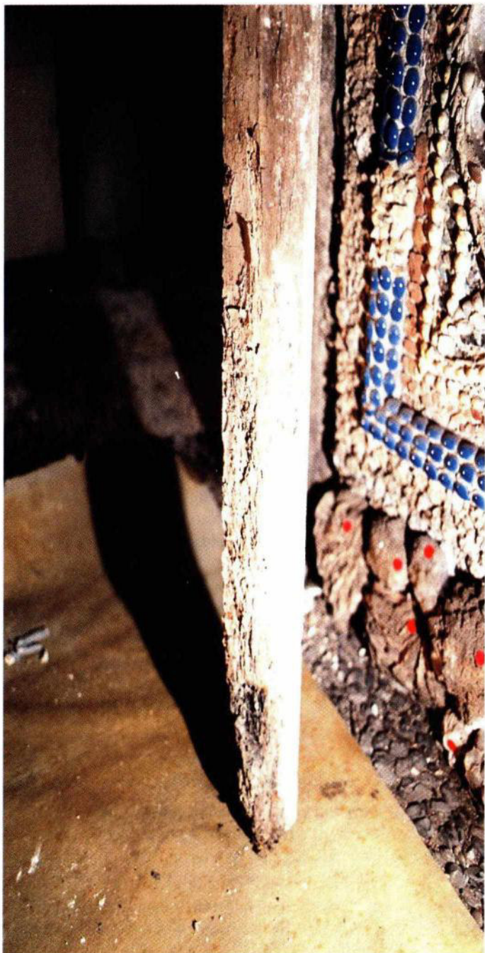
Abb. 9 Blendrahmenrückseite – Schadensbild, bewirkt durch Moderfäule und Anobienbefall. Grottenwerk (rechts) für den Rückbau markiert
